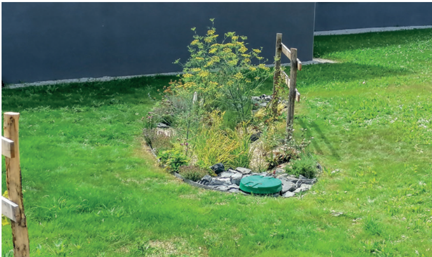
Installation d'un jardin de pluie Aquatiris composé d'une cuve 5000L Plast'eau suivi d'un jardin de pluie l'îlot filtrant®, de 14m 2 en infiltration totale pour une habitation individuelle en Ile et vilaine.
